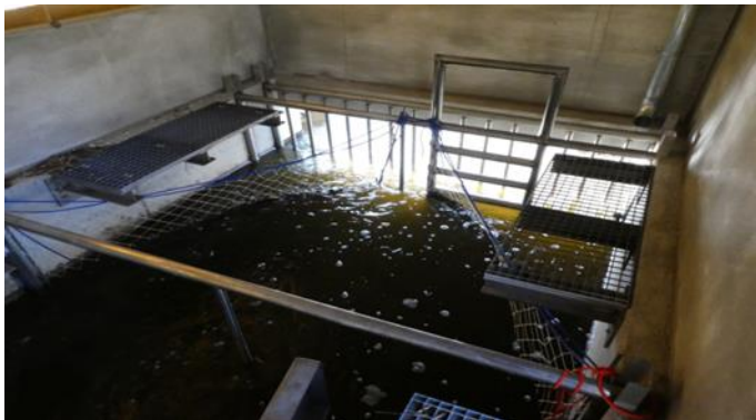
Abbildung 2: Gegen Vandalismus: Einhausung für Reuse und Stemmtor
